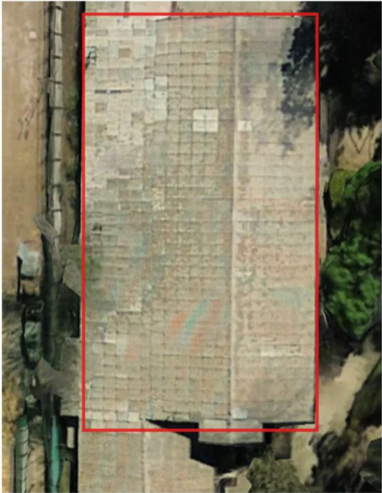
670 m2 de cubierta con Asbestos
